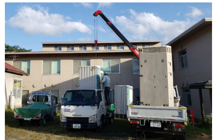
仮設トイレの設置。仕入先とも長い付き合い。気心知る関係です
