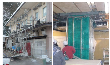
「幸雲閣」の建設工事。2016年当地に開業した大江戸温泉様も当社主要顧客のひとつです
